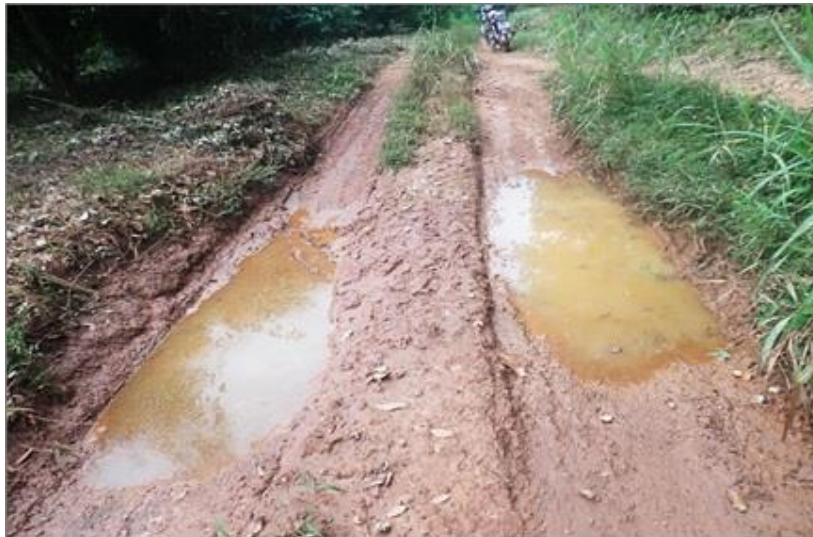
Photo 11: Flaques d'eau dans les empreintes de pneus sur la piste Chiépo-Sénikouassikro Cliché : Ogbapo, Sept.2015
