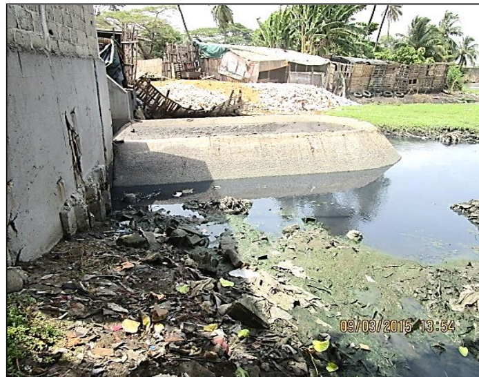
Photo 11: Déversement des eaux usées de la SODECI dans la baie de Marcory-Treichville
